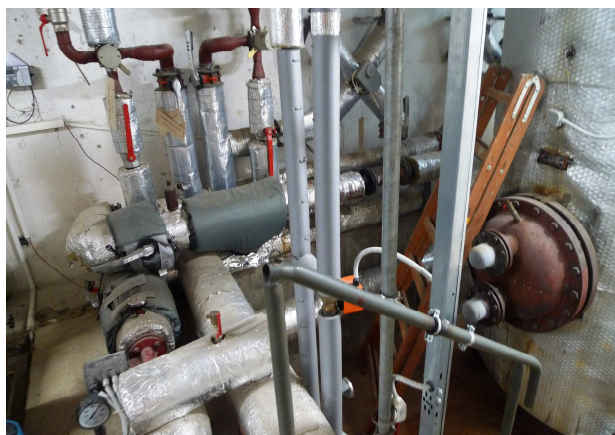
Foto č. 3 – Technická místnost
